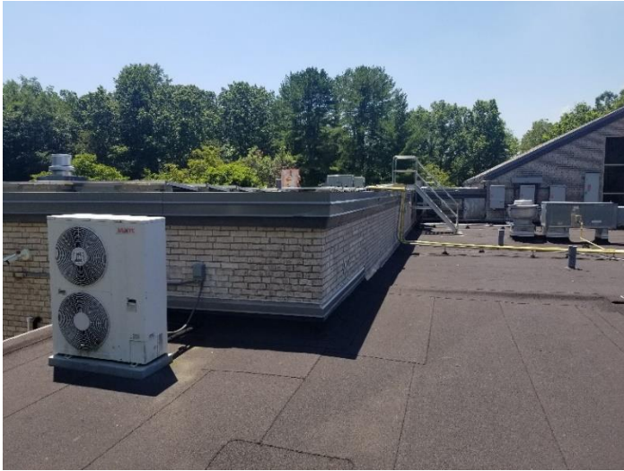
Existing Rooftop Mini Split Condenser
